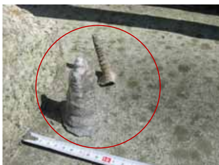
3階窓上部の庇上に見つかった コンクリートつららと石筍
