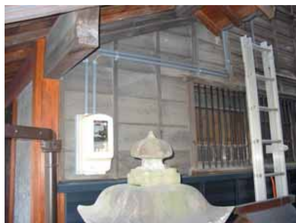
主屋 移動後の電気メーター
